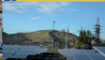
Granja Solar - Celsia
